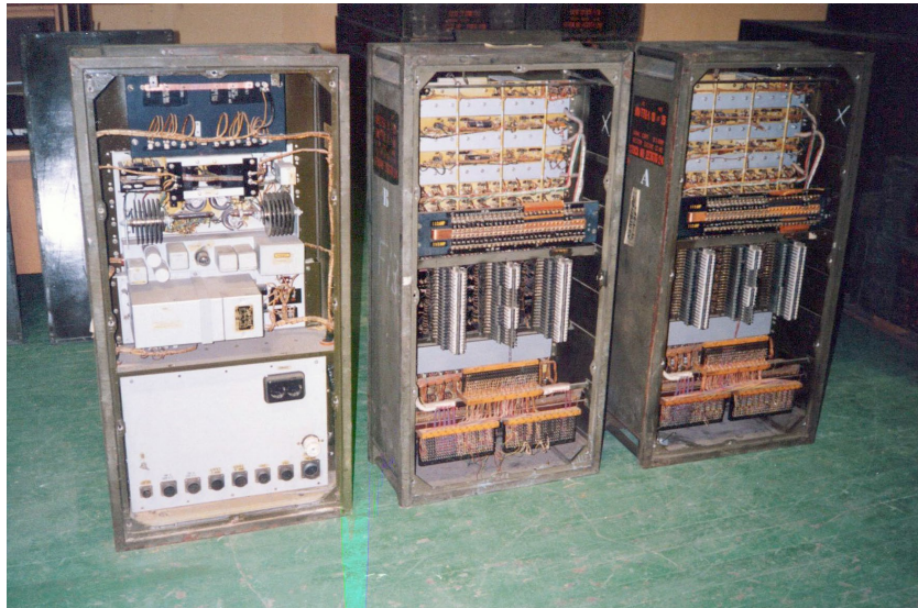
Bild 7. Fr.v strömförsörjningsstativ och två relästativ, baksidor.
