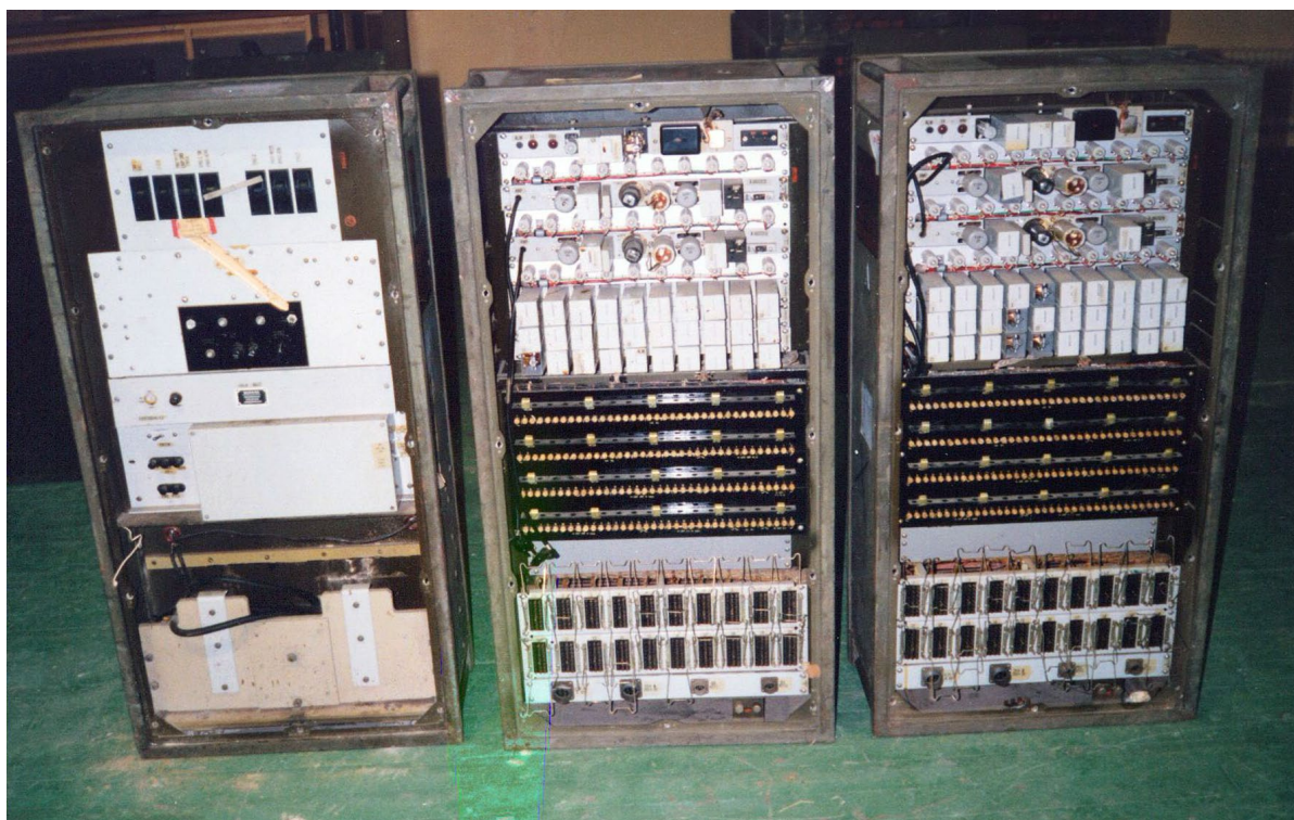
Bild 6. Fr.v strömförsörjningsstativ och två relästativ, framsidor.
